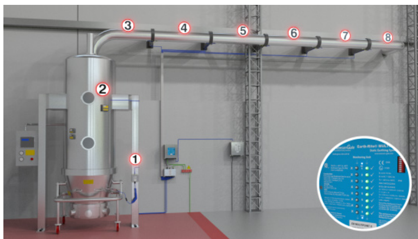
Questo esempio illustra la messa a terra e il monitoraggio di parti multiple del sistema di trasporto a rischio di isolamento da parte di Earth-Rite MULTIPOINT II
